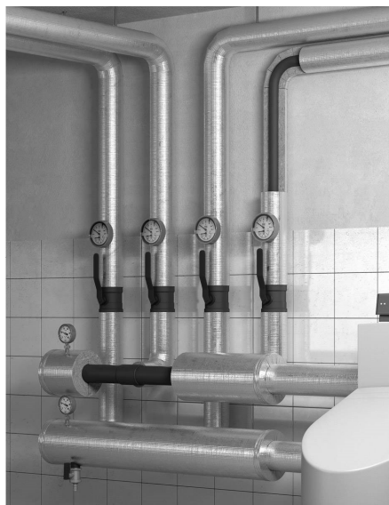
Rys. 3. Przedstawiające izolację instalacji pary wodnej z wełny mineralnej Źródło: [7]
